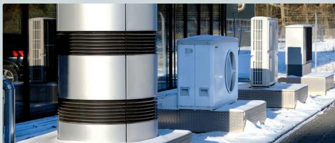
Vier Luft/Wasser-Wärmepumpen zum Heizen u. Kühlen vor dem Gebäude
